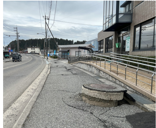
写真1 液状化によるマンホールの突出(珠洲市若山町)
