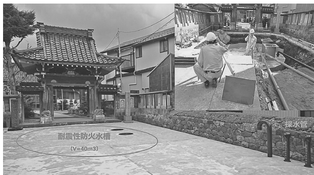
写真3 寺町台重伝建地区における寺院境内を活用した耐震性防火水槽（金沢市提供）
